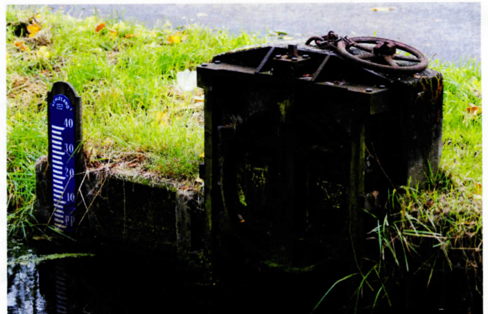
Schouwpeil met afsluitbare duiker © Arend Hoogeveen
